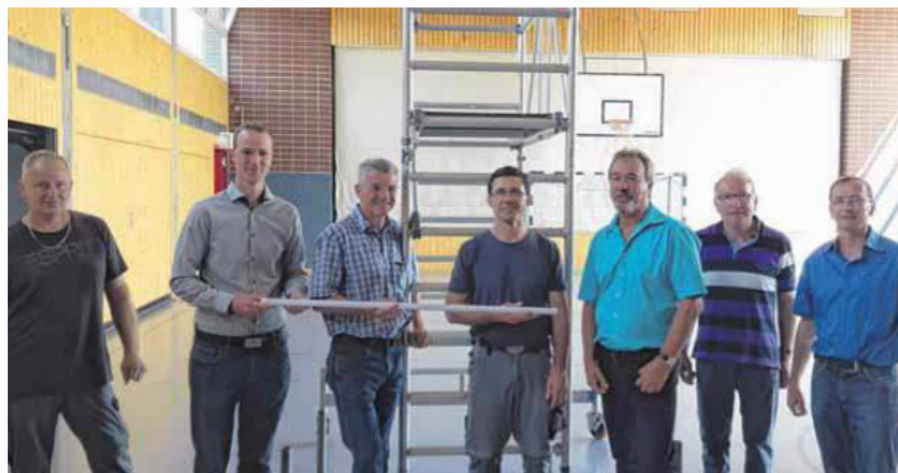
Die letzte Lampe ist ausgetauscht. Mit dabei waren (von links) Hannes Weißenburger, Hausmeister der Turnhalle, Manuel Natterer, Juniorchef bei Jamara, Bürgermeister Dietmar Lohmiller, Christian Sälzle von Elektro Sälzle, Erich Natterer, Seniorchef bei Jamara, Andreas Geissler und Berthold König von der Energiegenossenschaft.
