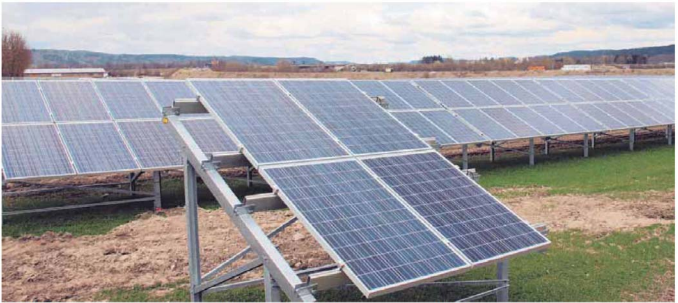
Die 101 000 Quadratmeter große PV-Anlage an der A 96 liefert laut Berthold König täglich rund 30 000 Kilowattstunden Strom.
