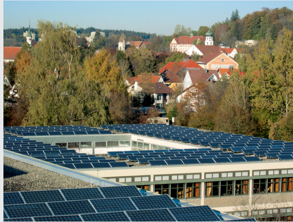
Die Photovoltaikanlage auf dem Schulzentrum in Leutkirch
